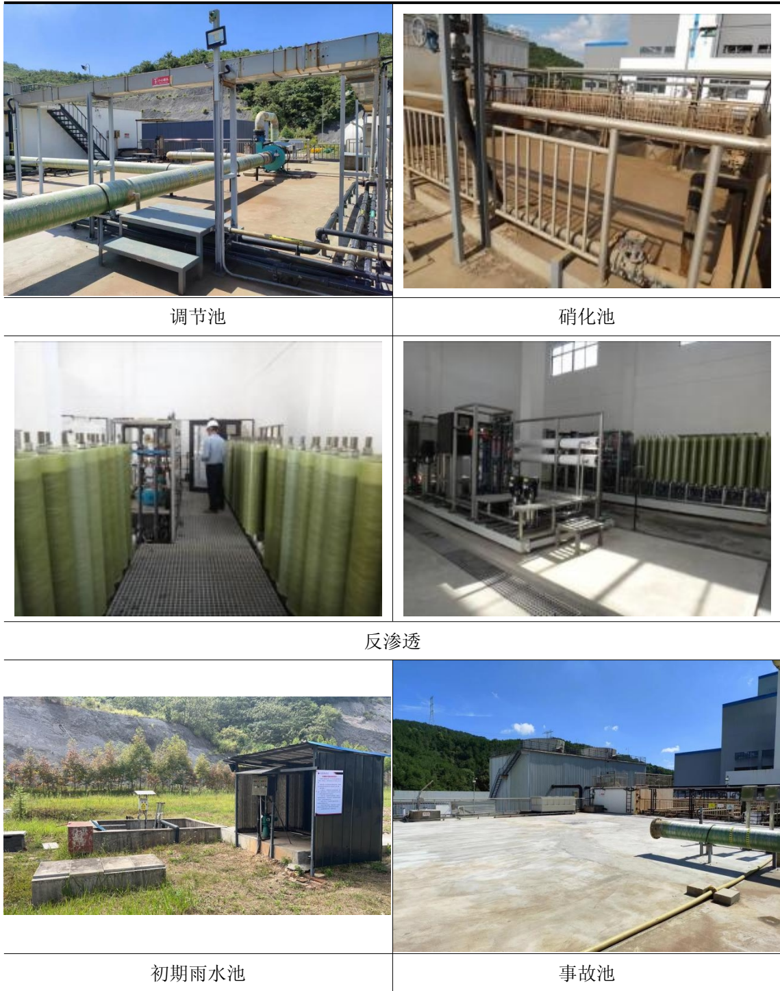
图 3.1-5 废水处理设施
